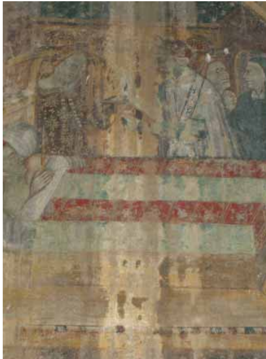
12. Dalla finestra posta in facciata continue infiltrazioni d'acqua hanno dilavato l'affresco sottostante.
