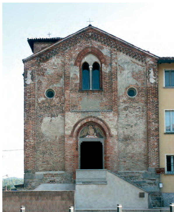
La facciata dell'Oratorio al termine dei lavori di conservazione, che hanno permesso tra l'altro di rimettere in luce gran parte dell'affresco trecentesco della lunetta del portale, raffigurante il Cristo nel sepolcro.
